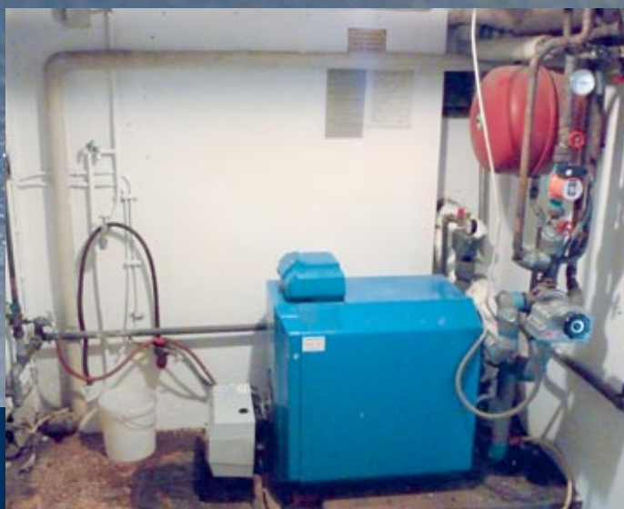
Die alte Ölheizungsanlage stammte aus dem Jahr 2001.
